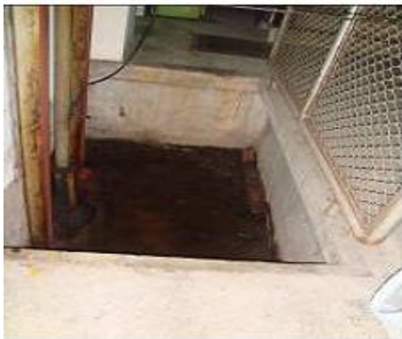
地下室之升降梯孔積水
