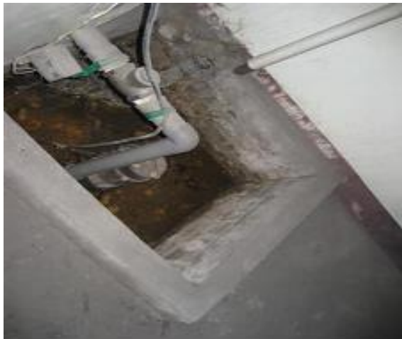
地下室儲水槽
